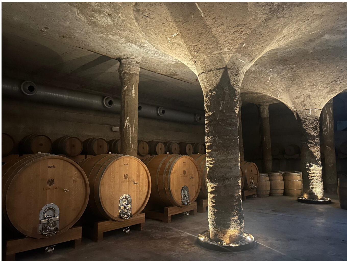
La barricaia e le colonne
